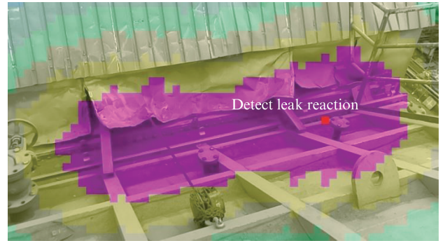
図4 集塵ダクトにおけるリーク検出状況（焼結工場） Fig. 4 Detection of leaks in dust collection ducts (sinter plant)
