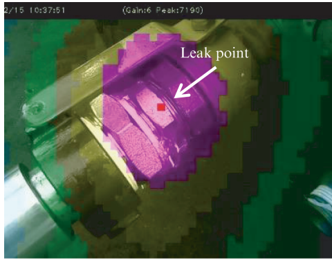
図5 リーク検出状況 (バルブ繋ぎ込み部) Fig. 5 Leak detection status (valve connection)
