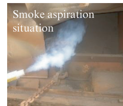
写真3 集塵ダクトにおけるリーク検出状況（焼結工場） Photo 3 Detection of leaks in dust collection ducts (sinter plant)
